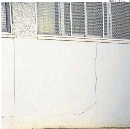
► Una de las grietas aparecidas en la trasera del colegio de Casetas.
