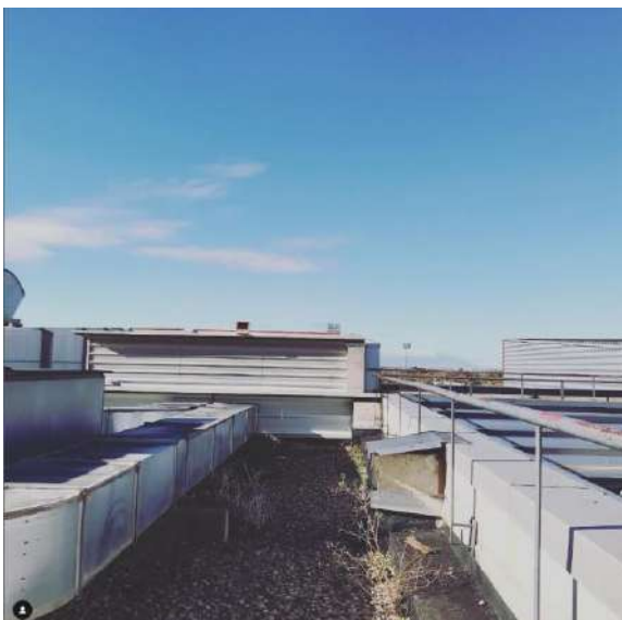
Imagen 2.- Caja nido de cernícalo instalada en la cubierta del Edificio Betancourt. Campus Río Ebro.
